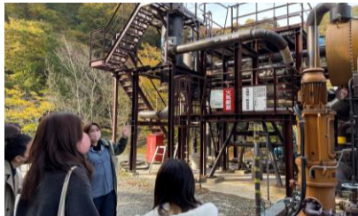
【地熱発電施設+源泉ガイド】
