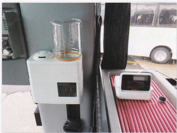
空間除菌装置の設置
